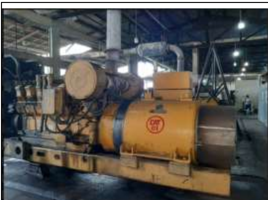
Motor Eléctrico en la Central Térmica de Requena
