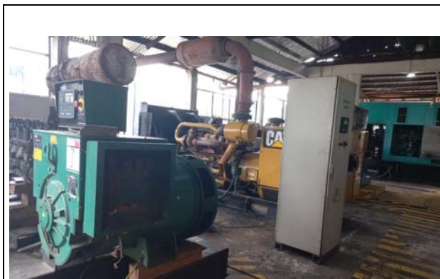
Foto de Central Térmica de Indiana
