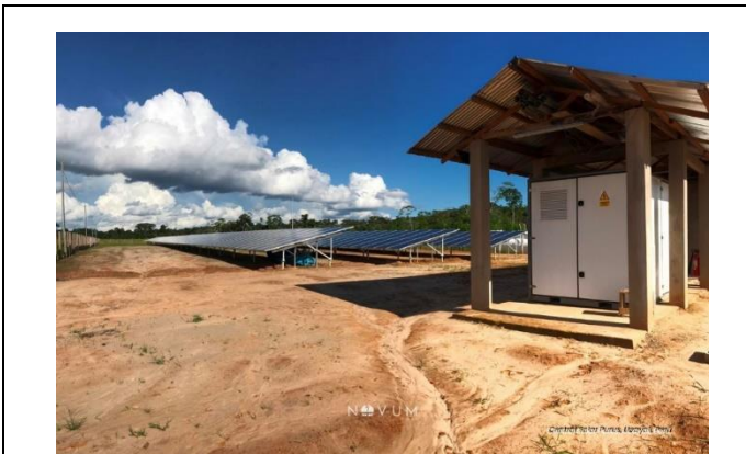
Centro de Operación de Planta Solar de Purus
