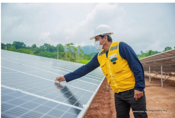
Mantenimiento a Planta Solar de Atalaya
