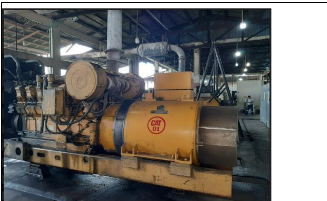
Motor Eléctrico en la Central Térmica de Requena
