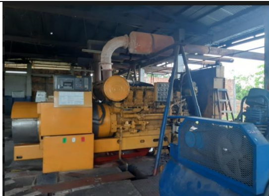
Foto de Motor Eléctrico de la Central Térmica
