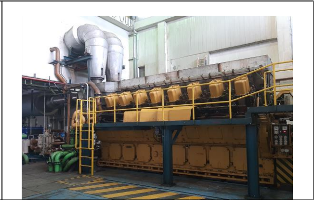
Planta Central Térmica Iquitos
