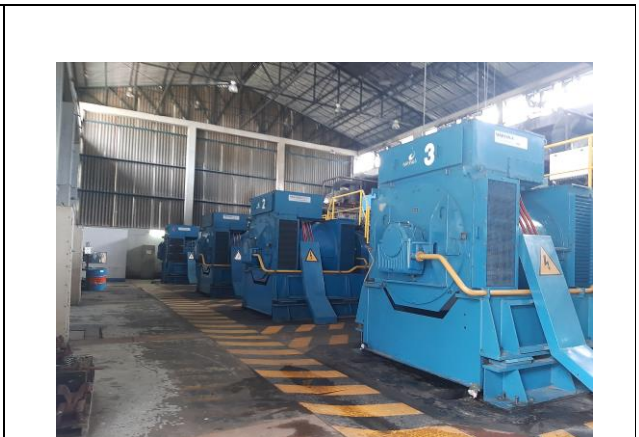
Planta Central Térmica Iquitos
